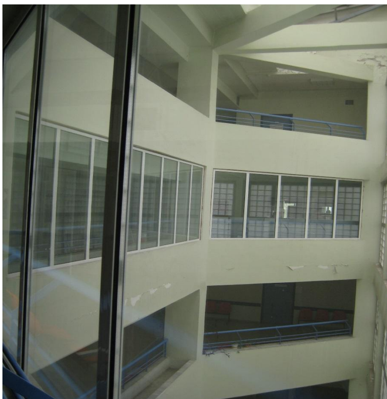
Εικόνα 7 : Φθορές επιχρισμάτων – Εξωτερικές υγρασίες λόγω ζημιάς σε αγωγούς υδρορροών
