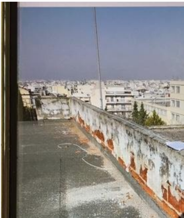
Εικόνα 1 : Εκτεταμένες φθορές επιχρισμάτων - Εξωτερικές υγρασίες Λάθη κατά τη φάση της κατασκευής ως προς το "γύρισμα" ασφαλτόπανου
