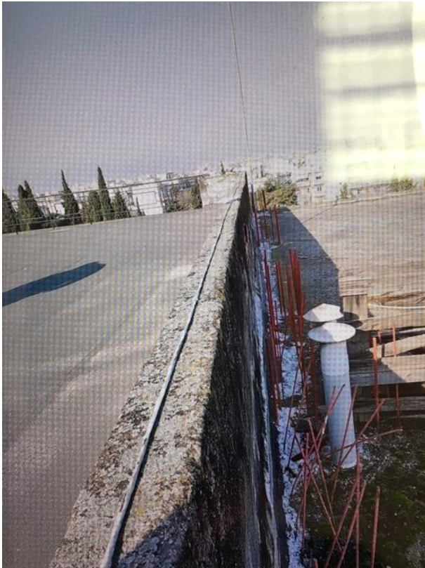
Εικόνα 2: Εκτεταμένες φθορές επιχρισμάτων - Εξωτερικές υγρασίες
