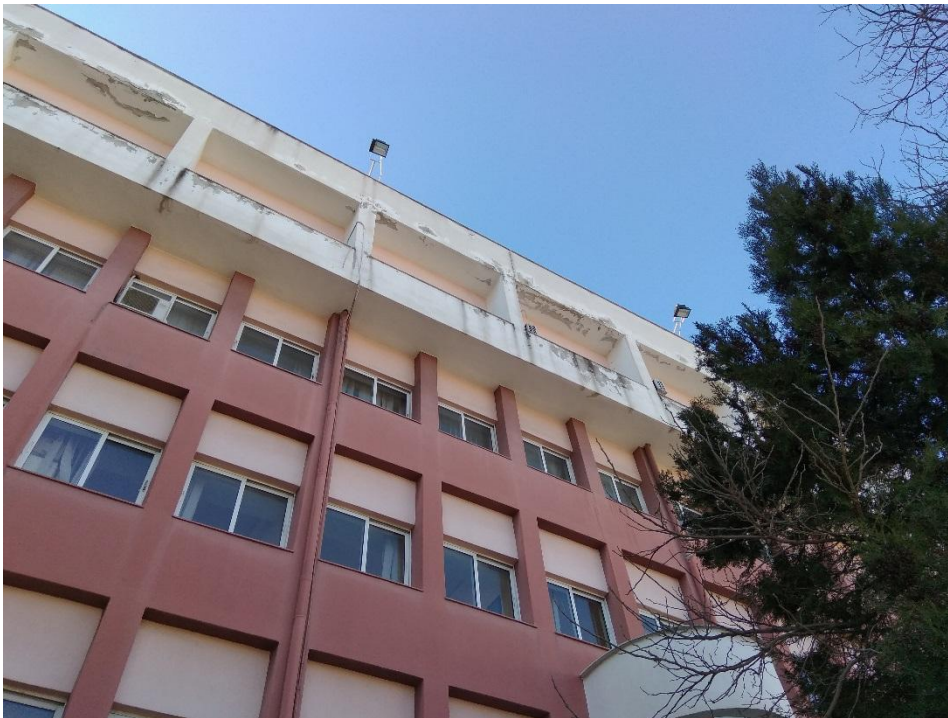
Εικόνα 5: Φθορές επιχρισμάτων - Εξωτερικές υγρασίες
