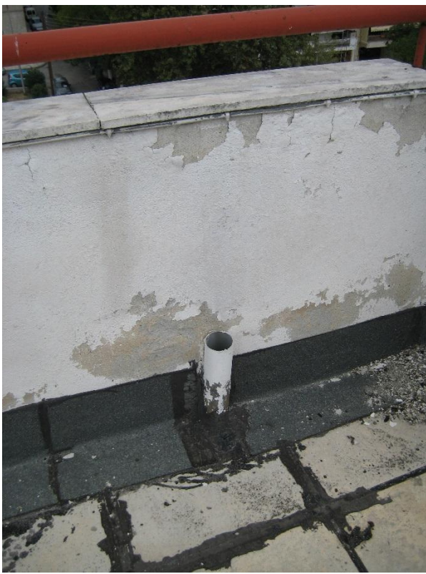
Εικόνα 9: Εσφαλμένη εφαρμογή ασφαλτικής μεμβράνης σε θέση υδρορροών
