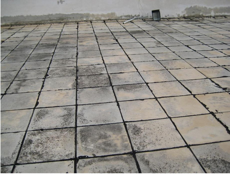
Εικόνα 2 :Αποσάθρωση πλακών επικάλυψης&Αστοχία υφιστάμενης υγρομόνωσης σε κατακόρυφα γυρίσματα των μεμβρανώνσε θέση στηθαίου
