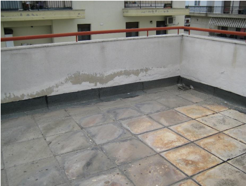
Εικόνα 4: Φθορές επιχρισμάτων - Εξωτερικές υγρασίες
