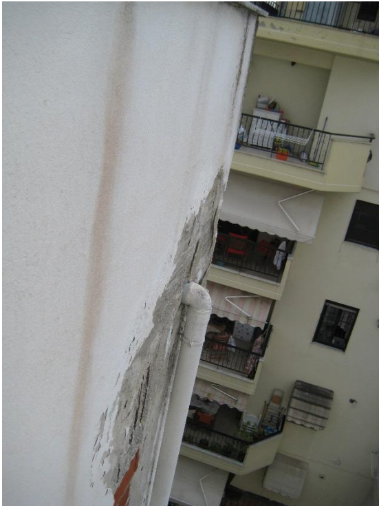
Εικόνα 8: Ζημίες σε εξωτερικούς αγωγούς
