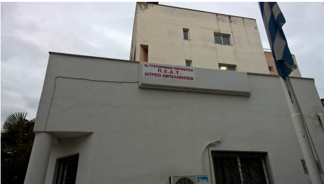
Εικόνα 3:Φθορές επιχρισμάτων - Εξωτερικές υγρασίες
