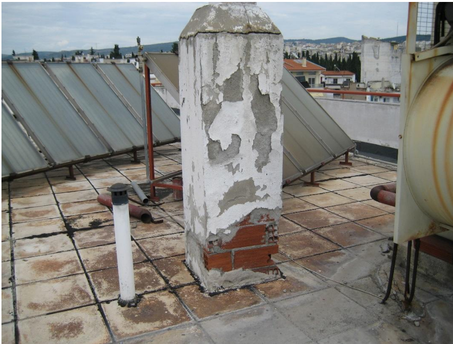
Εικόνα 1 : Αστοχία υφιστάμενης υγρομόνωσης σε κατακόρυφα γυρίσματα των μεμβρανών
