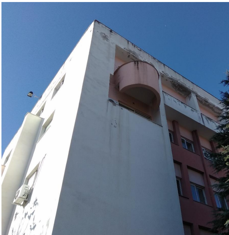
Εικόνα 6: Φθορές επιχρισμάτων – Εξωτερικές υγρασίες λόγω ζημιάς σε αγωγούς υδρορροών
