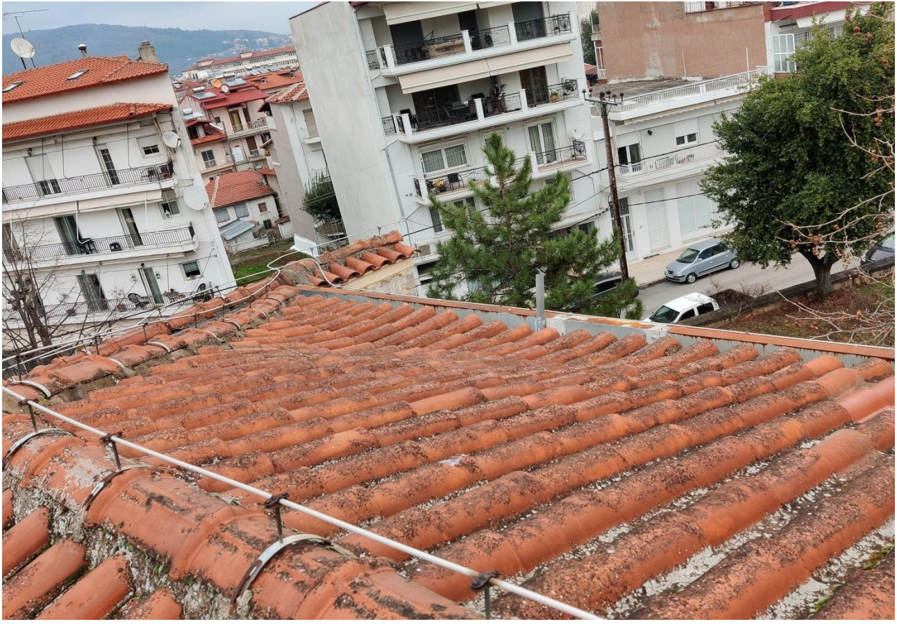
Εικόνα 4: Φθορά - καθίζηση στέγης ανατολική όψη
