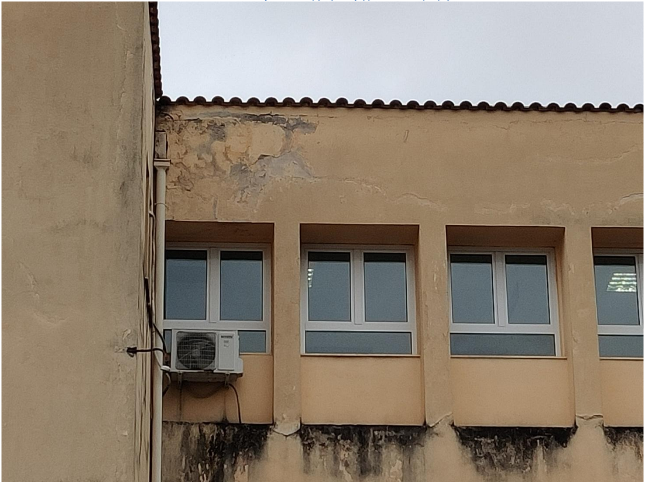
Εικόνα 5: Φθορά στη συναρμογή με την κατακόρυφη υδρορροή
